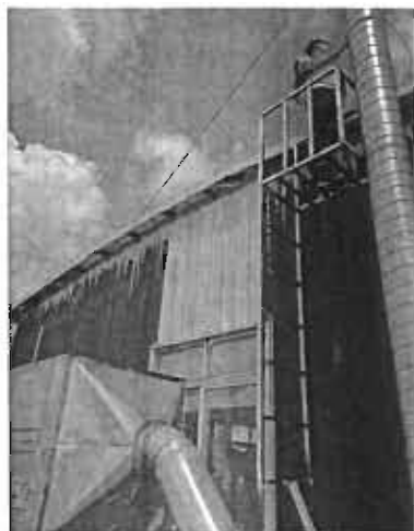
涂布、烘干工序废气排放口 2#
