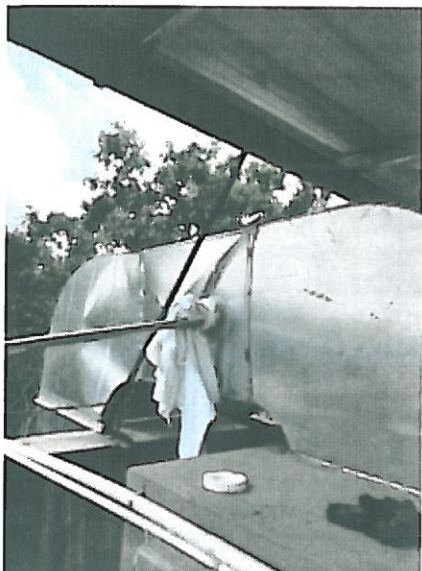
有组织废气：喷漆废气处理前采样口
